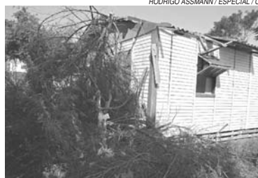
No interior de Vera Cruz, parte de casa ficou destruída
