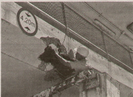
Dano a estrutura na Terceira Perimetral pode ter sido causado por caminhão
