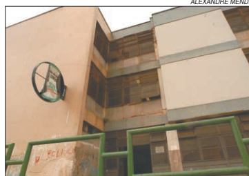
Comunidade aponta a precariedade da estrutura de atendimento veio apenas quatro horas depois. Outra reclamação se refere ao isolamento de pacientes com suspeita de tuberculose, que ficam ao lado do plantão pediátrico e do refeitório dos servidores. A situação chegou a ser denunciada, em julho, pelo Sindicato Médico do RS (Simers), que entregou um dossiê sobre o local ao prefeito José Fogaça.
